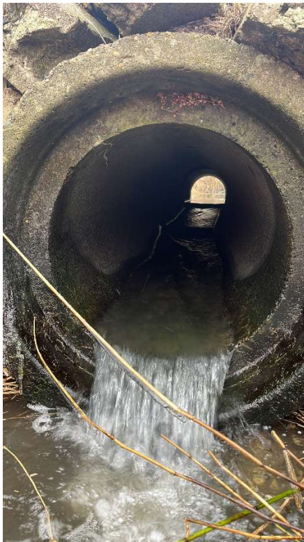
Billede af udløb, spærring ved station 2.358 – 2.364.
